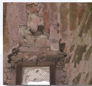
Stark geschädigtes Ziegelmauerwerk.
