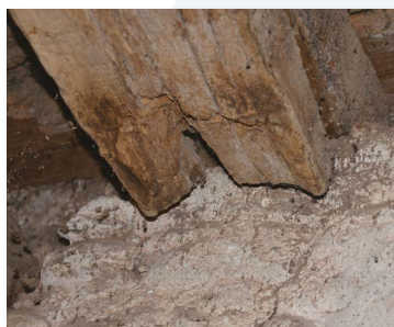
Fäulnisschäden in den Auflagerbereichen der Deckenbalken.
