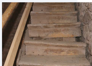
Schäden / Abnutzung Treppenaufgang, provisorisches Geländer.
